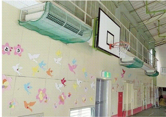
別府支援学校石垣原校の体育館に設置している空調設備。別府市鶴見
