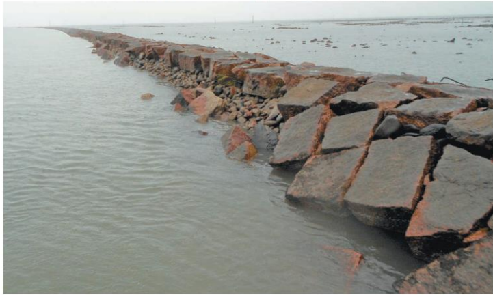
豪雨で地盤が削られ損壊した導流堤。被覆石が剥がれ落ちた＝9日、中津市小祝漁港
