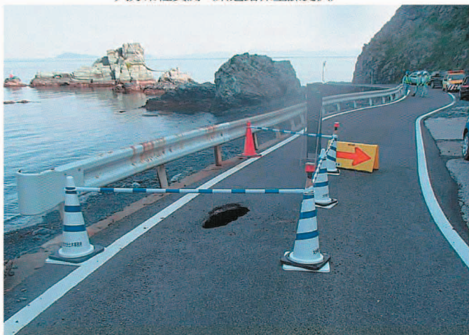
県道佐賀関循環線の陥没＝5月下旬、大分市佐賀関（県道路保全課提供）
